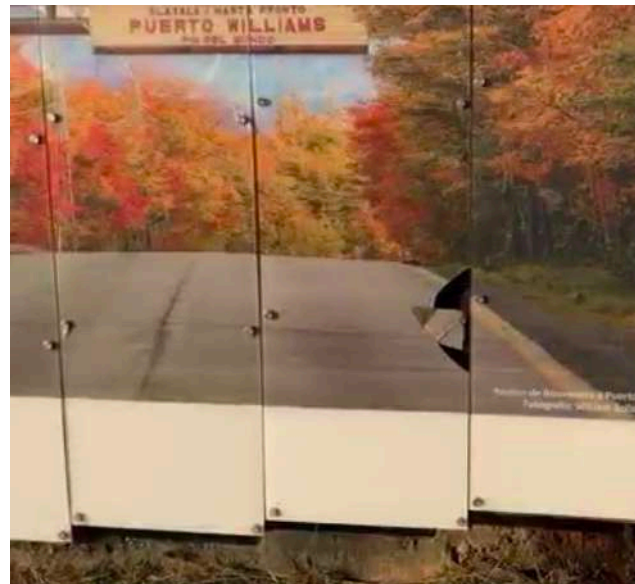
En estas condiciones quedó el muro ubicado en el acceso de la localidad.
