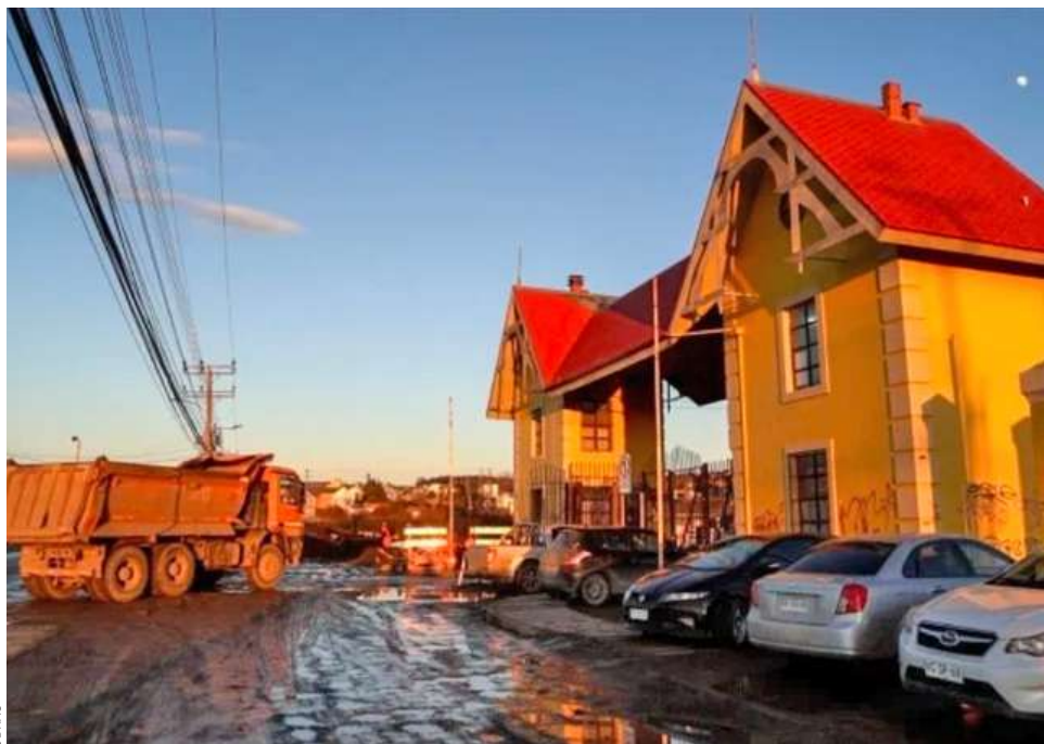
La constructora a cargo del nuevo cierre perimetral debía costear su propio empalme, pero consumía electricidad a costa del presupuesto comunal.
