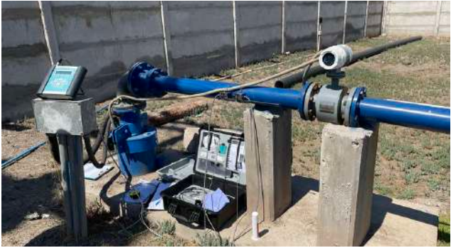
Cuando existan problemas con las transmisiones de alguna obra de captación, se podrá identificar el centro de control respectivo y corregir.
