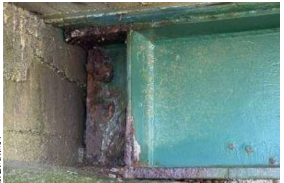
Fotografías tomadas por fiscalizadores de la Contraloría Regional de Magallanes al Puente Penitente, con fecha 8 de octubre de 2025.
