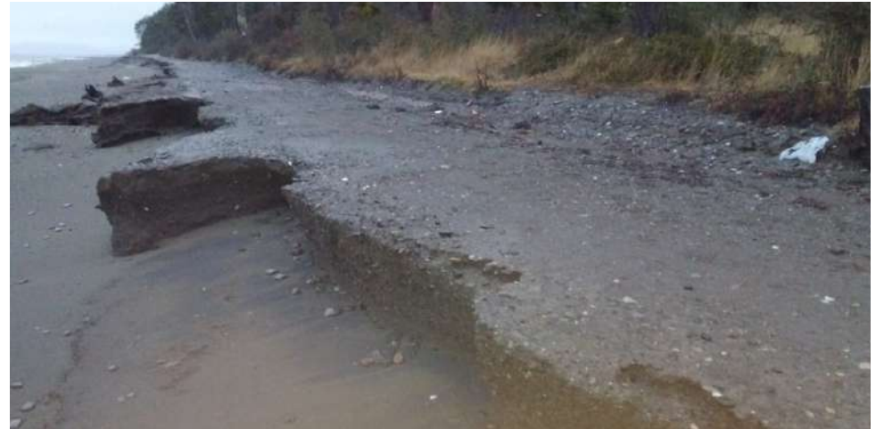
En estas condiciones había quedado el camino debido a las fuertes marejadas, pero fue reparado rápidamente.
