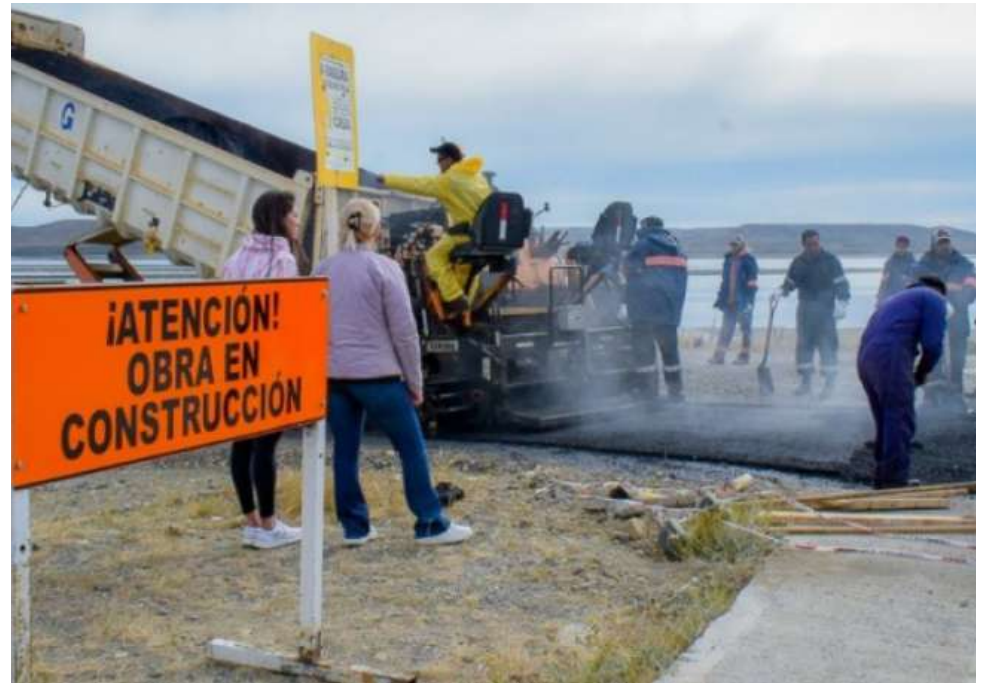
Los trabajos se desarrollan en la intersección de Almirante Brown con Juan Manuel de Rosas.
