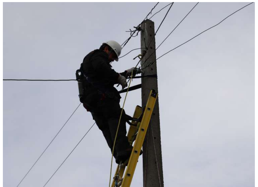
Las personas se ponen en riesgo al momento de realizar estas prácticas, ya que podrían sufrir una descarga eléctrica.
