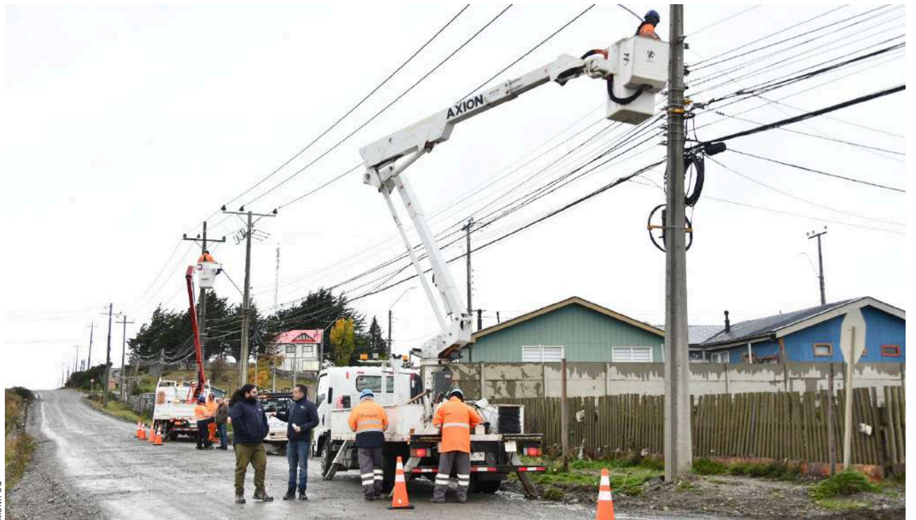
La iluminación se traduce en más seguridad para la comunidad.
