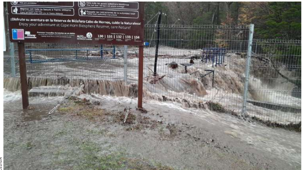
Este es el sector donde se reflejó el colapso de la boca toma, debiendo intervenir maquinaria para evitar que se dirija hasta otro sector.
