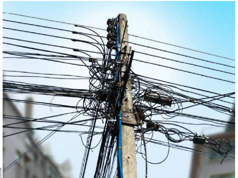
En 2027 las empresas deberán realizar el retiro de sus cables que ya no estén operativos.
