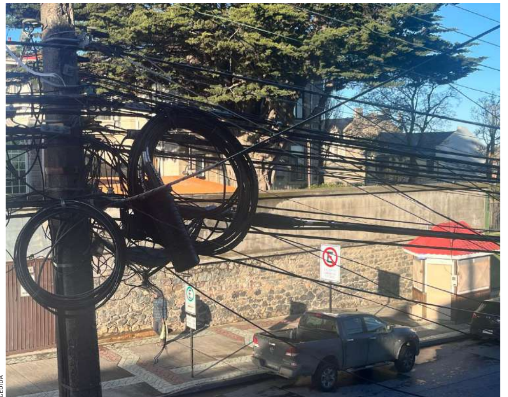
Son varios los postes de diferentes calles recargados de cables.
