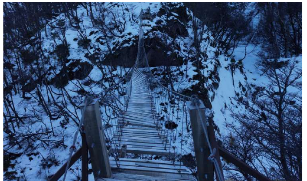
El puente quedó completamente dañado, de acuerdo con la información de Conaf. La estructura tiene más de 50 metros de longitud.
