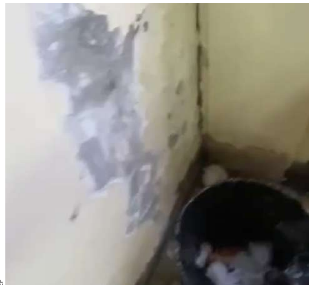
La pared "de la discordia" al interior del Liceo Politécnico.
