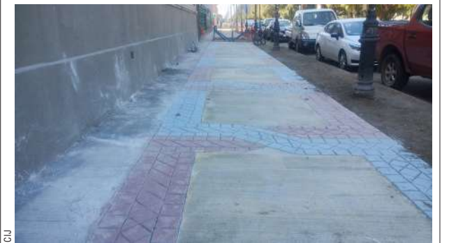
Un progresivo avance, con la instalación de nuevas aceras de hormigón estampado, presentan los trabajos que se ejecutan en el frontis del Santuario María Auxiliadora y que cuentan con una inversión de $280 millones por parte de la Municipalidad de Punta Arenas.
