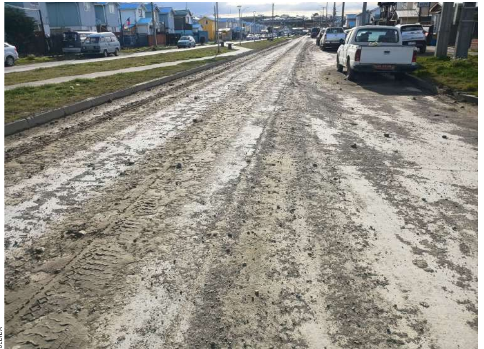
Dentro del radio urbano se puede apreciar como el mal manejo de estos elementos provocan daños en las calles de la ciudad.
