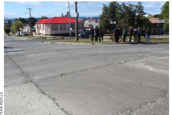
Avenida España con calle Bellavista, donde se evidencia el avanzado deterioro de la calzada.
